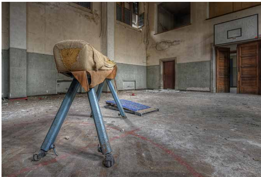
So schlimm wie in dieser Sporthalle kommt es selten, doch viele Einrichtungen sozialer Infrastruktur in Deutschland sind sanierungsbedürftig.
