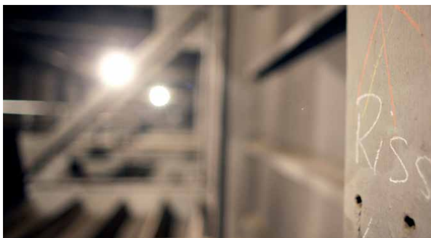
Riss im Inneren der Rheinbrücke bei Leverkusen (Foto vor der jüngsten Sanierung). Heute ist die Brücke für LKW wieder gesperrt.
